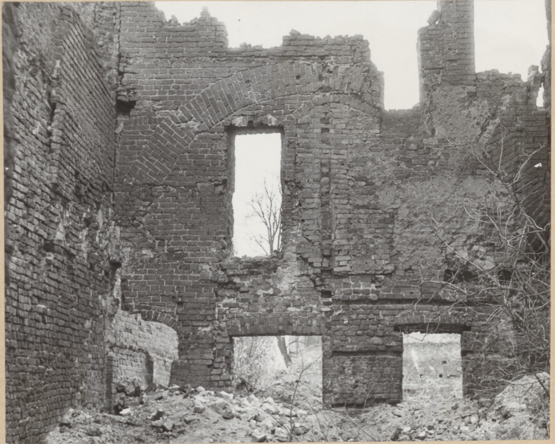
28. Kamieniczka nr 2. Sciana południowa od strony wnętrza. Widoczne późniejsze przemurowania i wyprucia wątku gotyckiego.
