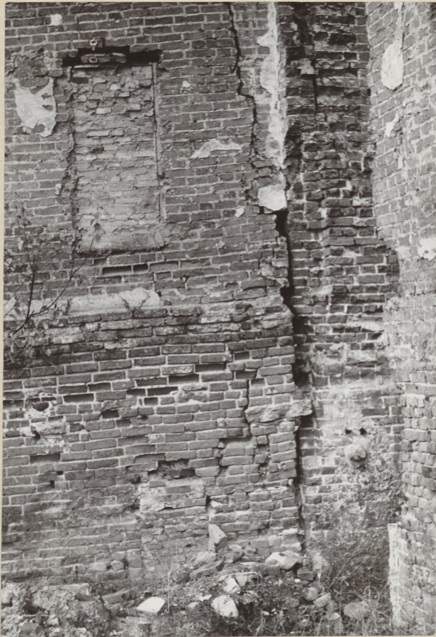
15. Fragment fot. 14. Styk zachodniej ściany przybudówki z elewacją zachodnią kamieniczki nr 3. Widoczny brak powiązania.
